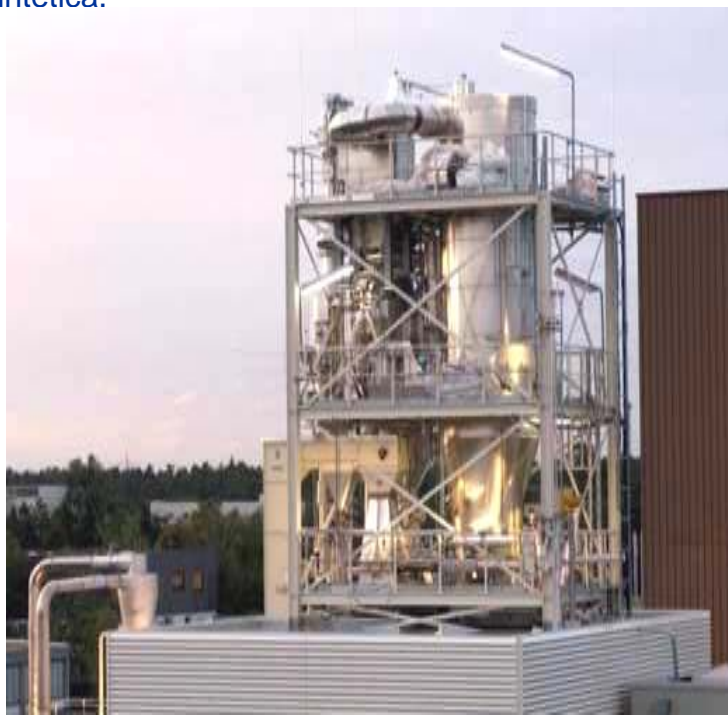
Impianto pilota di pirolisi in Karlsruhe - Germania
